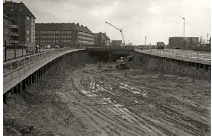
Bau der Unterführung Ostring im Verlauf der Bundesstraße B 76 (Segeberger Straße), April 1972, StAK 52821, Fotograf Friedrich Magnussen
